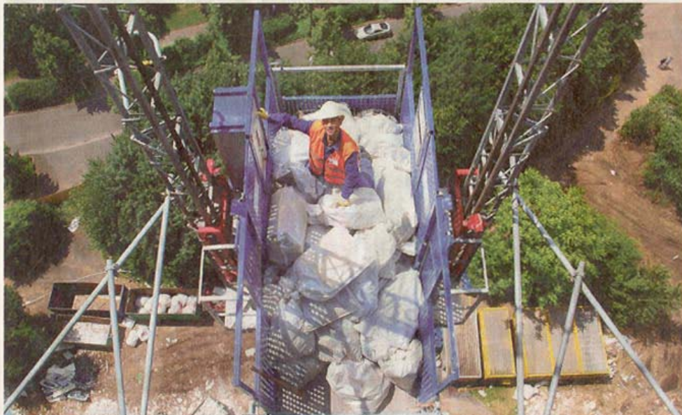
Entkernung pur: Per Lastenaufzug werden mit Schadstoffen belastete Materialien Stockwerk für Stockwerk aus dem Goliath geschafft. Fotos: WAZ, Jürgen Metzendorf
