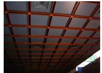
Holzschutzmittel: PCP/Lindan in Abhangdecke
